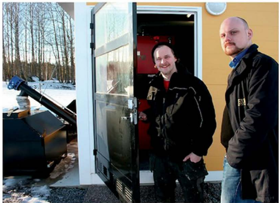
Projektansvarige David Ahlezon och vd Niklas Ahlezon vid företagets nya flisvärmelanläggning - en ekonomisk satsning på närmare 2,5 miljoner kronor. FOTO: JOHAN ERIKSSON
